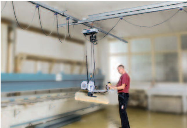
Poutre roulante (système monopoutre) en acier, charge de 250 kg, 6x12 m
